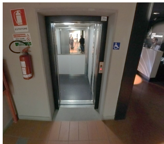
10 ascensore dentro Palazzina Uzielli
